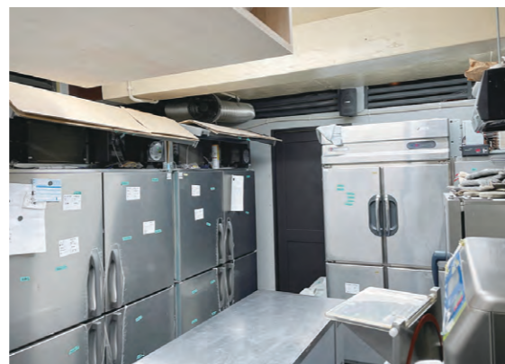
補助金で導入した設備の一部
