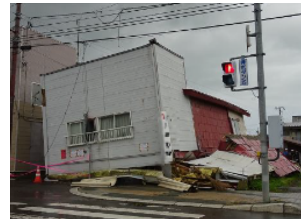
店舗の倒壊（むかわ町）
